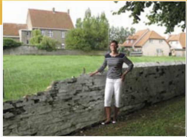
Buurtbewoonster Inge Van Buynder-Seys zal blij zijn als de herinrichting van Vlissegem dorp achter de rug is, en de kerkhofmuur keurig hersteld is.
